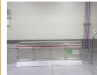
시설 | 분말혼합탱크 용량 | 1.5ton
